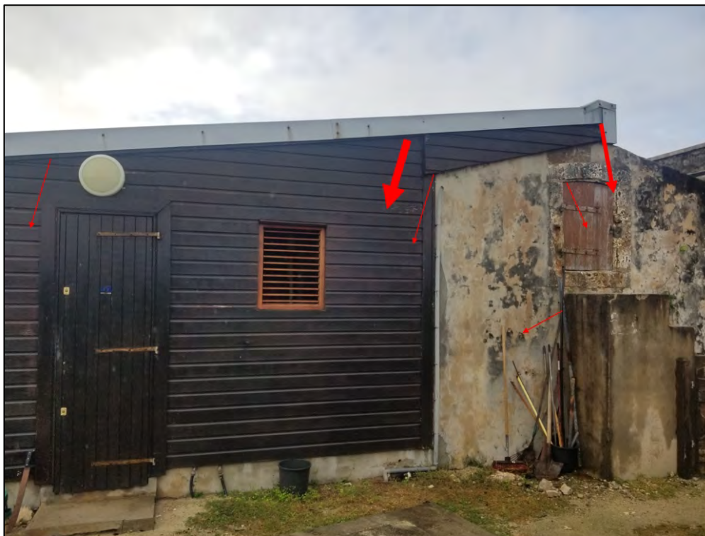
Figure 5 : Localisation des trous de sortie sur la façade Nord de la maison des gardes.
