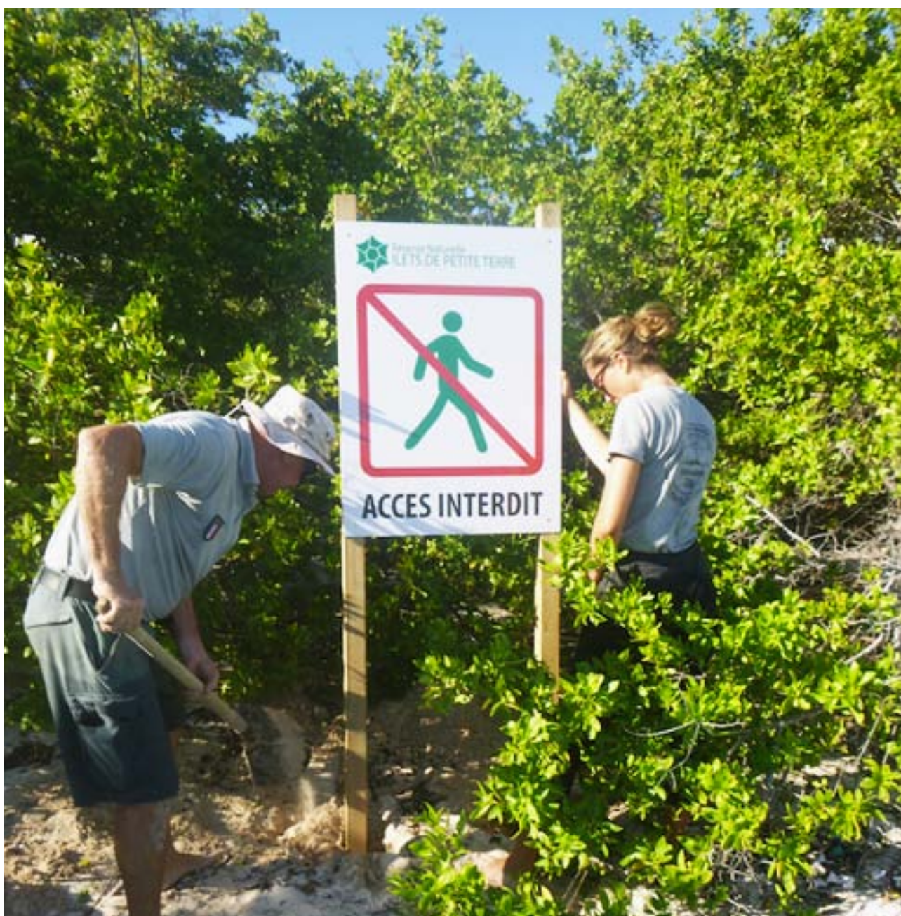
Pose du panneau d'interdiction d'accès à Terre-de-Haut le 27/09/2019 © A. LE MOAL
